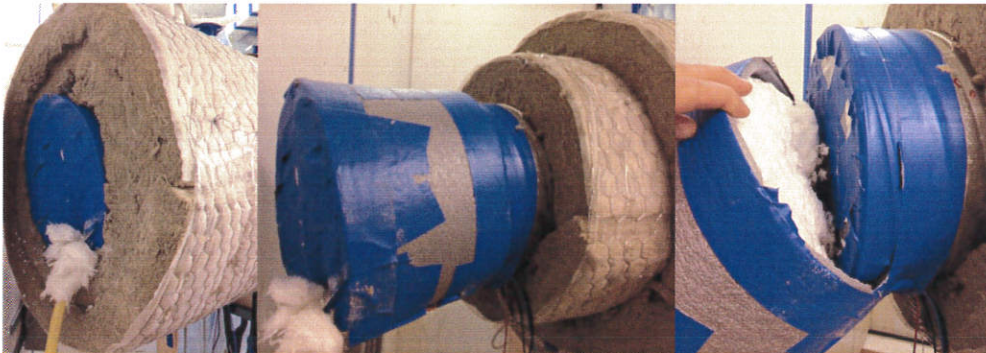
Figur 12 Ändlocksisolering på anslutningssidan med utstickande 160mm isolering. Bilden till vänster visar det fullt isolerade fallet (160mm) vid mättillfället. Mittbildens visar den utstickande ändlocksisoleringen (lösull). Bilden till höger visar blottläggningen av ändlocket på anslutningssidan.
