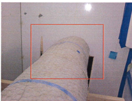
Figur 19 Termografering av den borte ändens ovsida av kanalen i mätfall: 0Pa, söndertrampad 50mm isolering.
